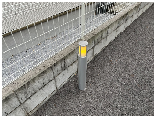
照明は正しく作動している
