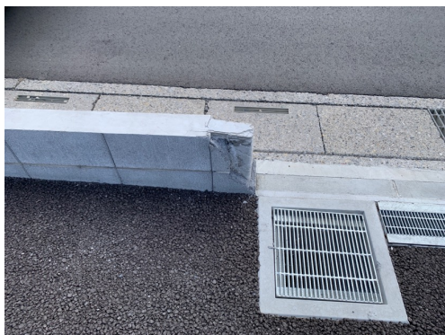
外壁が剥がれている
