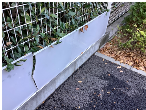
フェンスが壊れている
