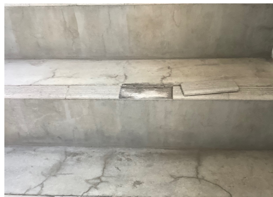
タイルが剥がれている
