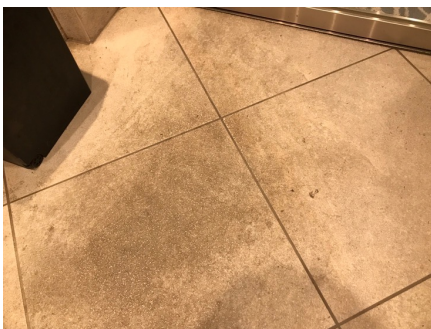
フロアが汚れている
