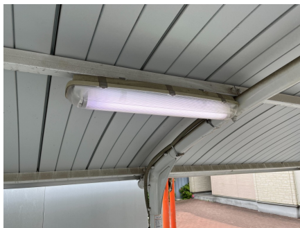
照明は作動している
